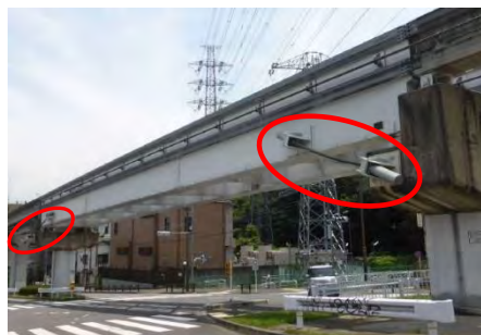
落橋防止装置を設置した軌道桁
