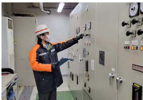
変電設備の点検
